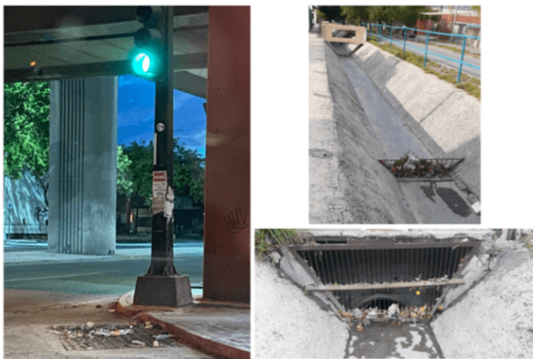
Figura 1. Alcantarillas obstruidas con residuos en Nuevo León, México.
